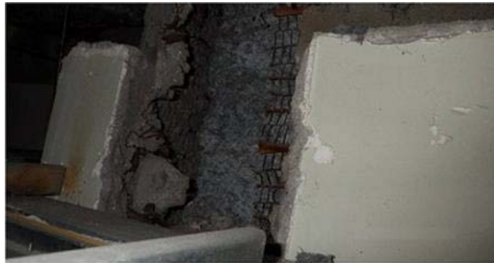
（参考資料）写真6－2 壁の中に青石綿が吹付けられた例
